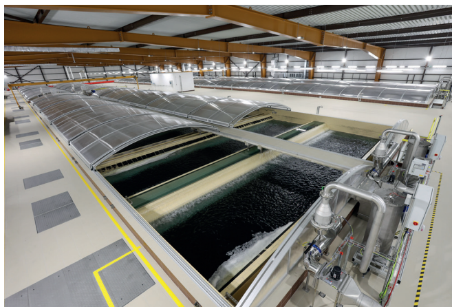
Úprava vody Želivka - filtrační hala s GAU
